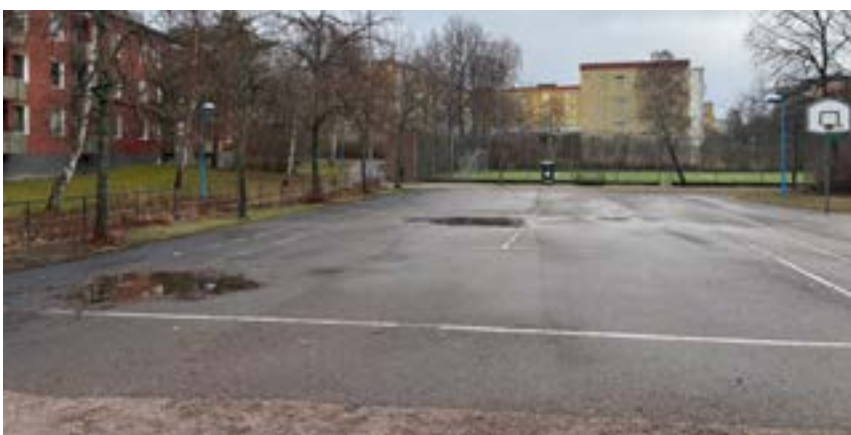
Bild 19. Sättningar i asfaltsytan i parkens övre del.
