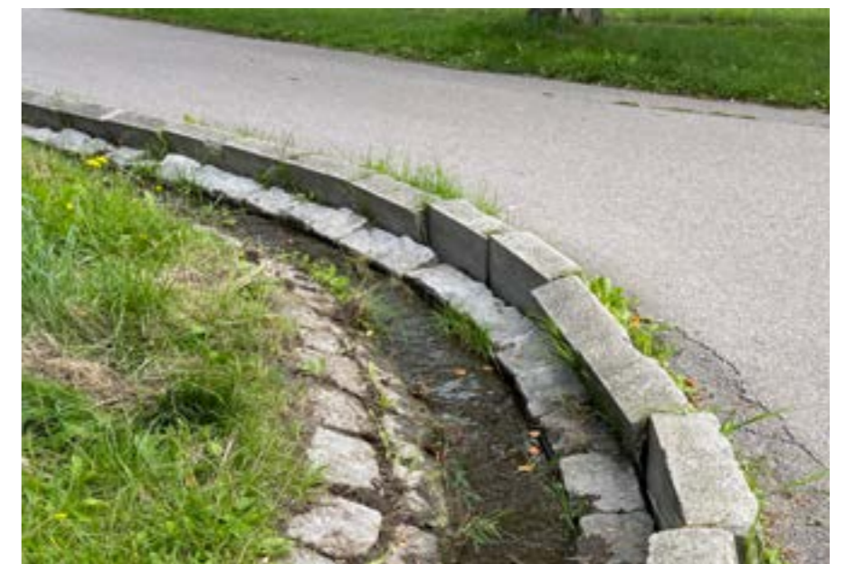
En del av vattenflödet med kranvatten till dammen, löst sittande kantstenar ger ett slitet intryck.
