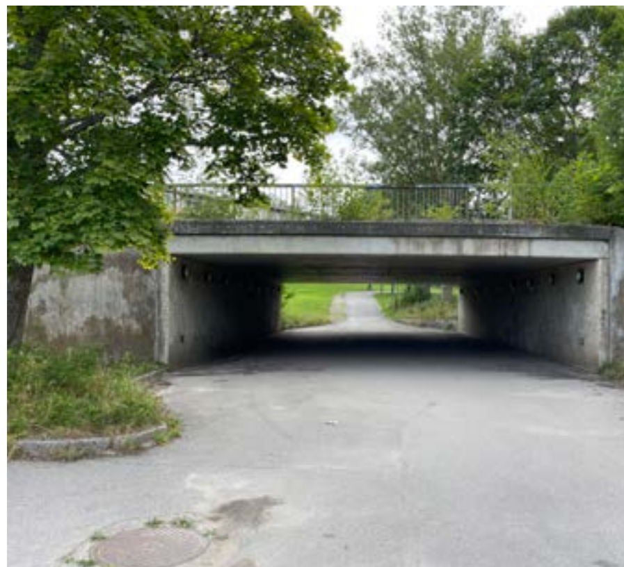
Parkens östra entré genom gångtunneln. Tunnelns tak och sidor är bevuxna av sly och ogräs, betongen är slitna och bär spår av klotter.
